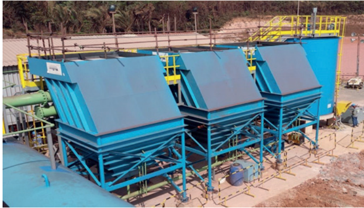
Figura 5 – Foto Clarificador de Lamelas
