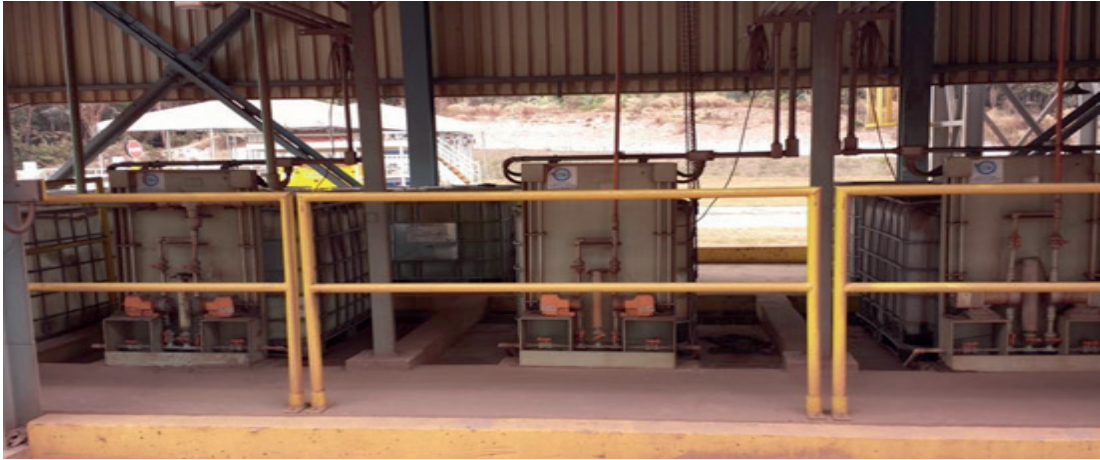
Figura 10– Bombas Dosadoras Produtos
