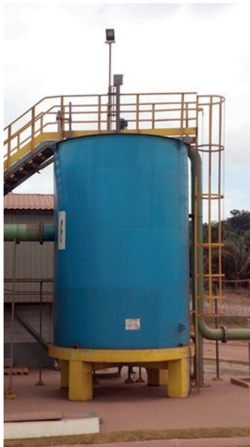
Figura 11– Tanque de Floculação
