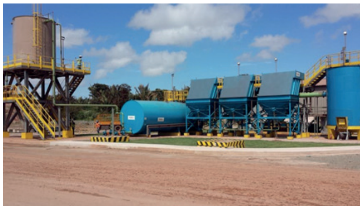
Figura 4 – Foto Estação de Tratamento de Efluentes Industriais
