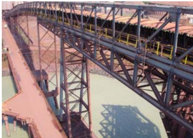
Figura 01: Visão Geral do Transportador TR-315K-03-Atual
